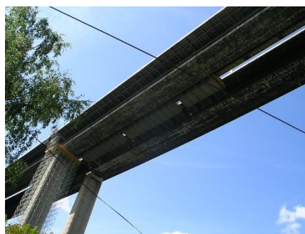
Je právě v rekonstrukci a zdá se mi zespodu jakýsi orezlý. Doufejme, že jen povrchově.
