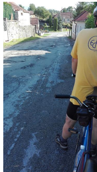
Silnice v Březině je v úplně šíleném stavu, jak v nějaké dřevně na Sibiři.
